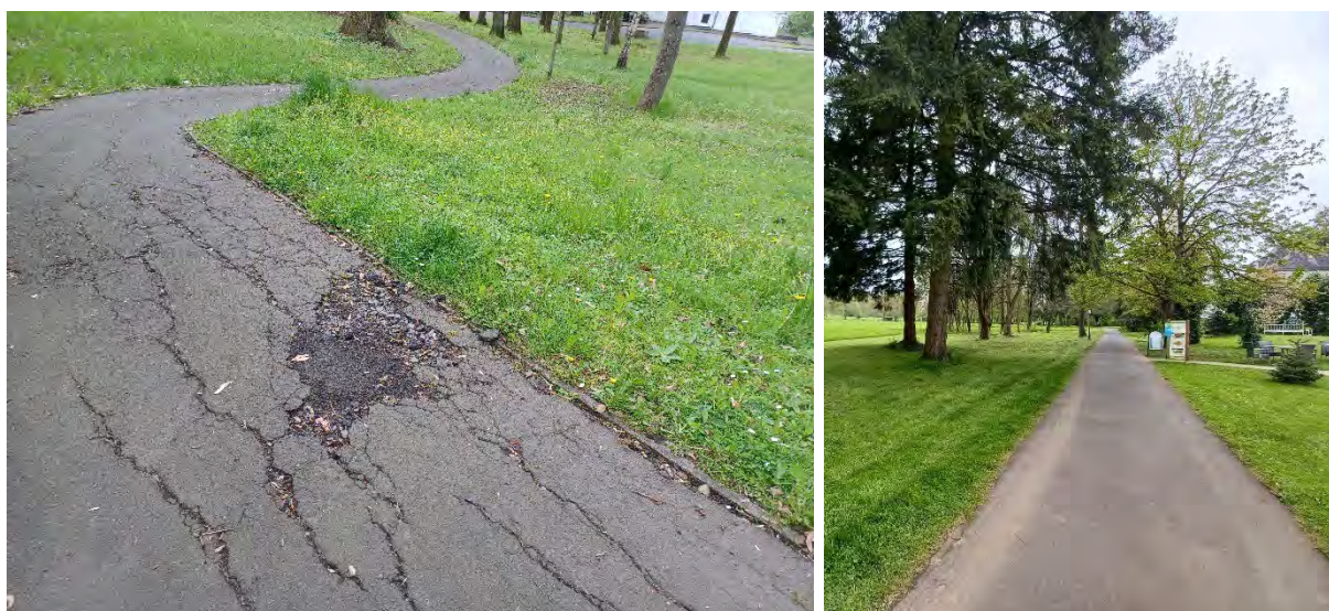
Asphaltierte Wegeflächen im oberen (links) und unteren (rechts) Kurpark
