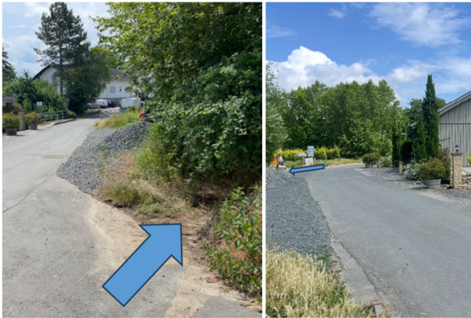
Abbildung 7: Entwässerung des Wirtschaftsweges zum Welzbach, April 2024
