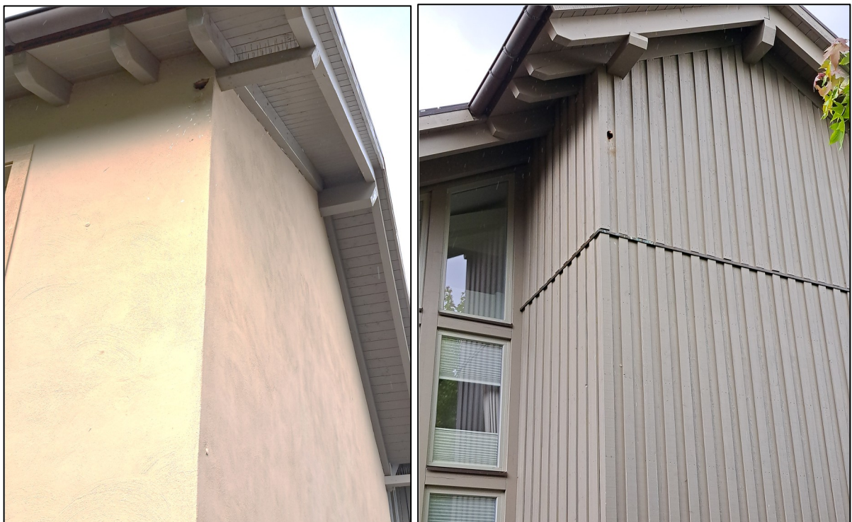
Abb. 15: Spechtlöcher in der Außenfassade der Bestandsgebäude (IBU, 2024)
