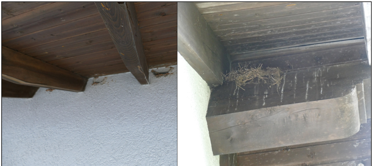
Abbildung 11: Überreste von Schwalbennestern unterhalb des Dachvorsprungs im Süden des Verwaltungsgebäudes (links) und Vogelnest auf dem Firstbalken (rechts) (Foto: IBU Juni 2025).
