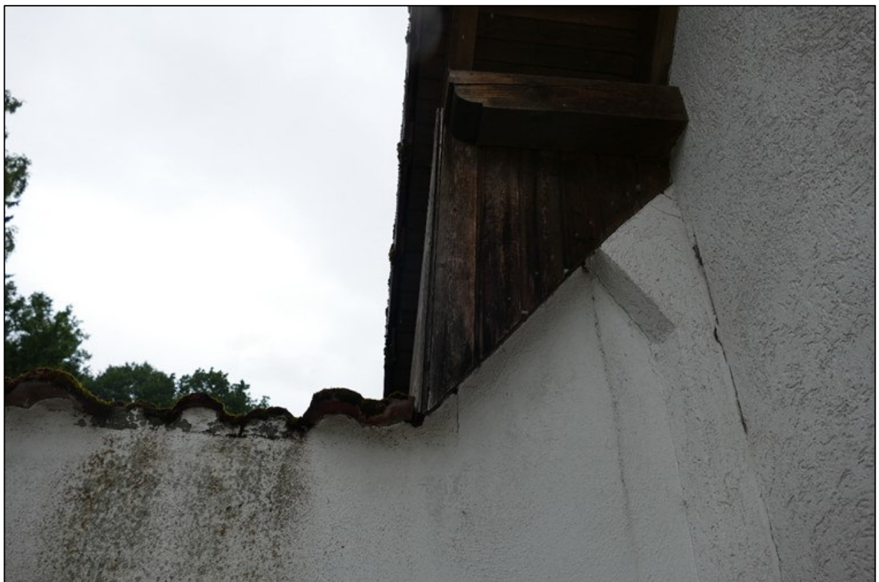
Abbildung 9: Holzverkleidung im Bereich der Fassade (Foto: IBU Juni 2025).
