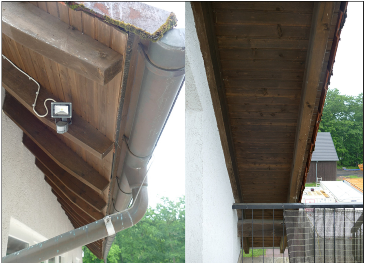
Abbildung 8: Die Dachüberstände sind mit Holz verkleidet und teils über Spalten von für Kleintiere wie Fledermäuse zugänglich (Foto: IBU Juni 2025).
