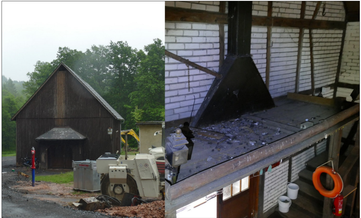
Abbildung 14: Scheune im Norden des Plangebiets mit größerer Dachöffnung und Kratzspuren an der Fassade (links) sowie Kotschutt eines Raubtieres auf einem Dachvorsprung im Innenraum (rechts) (Foto: IBU Juni 2025).
