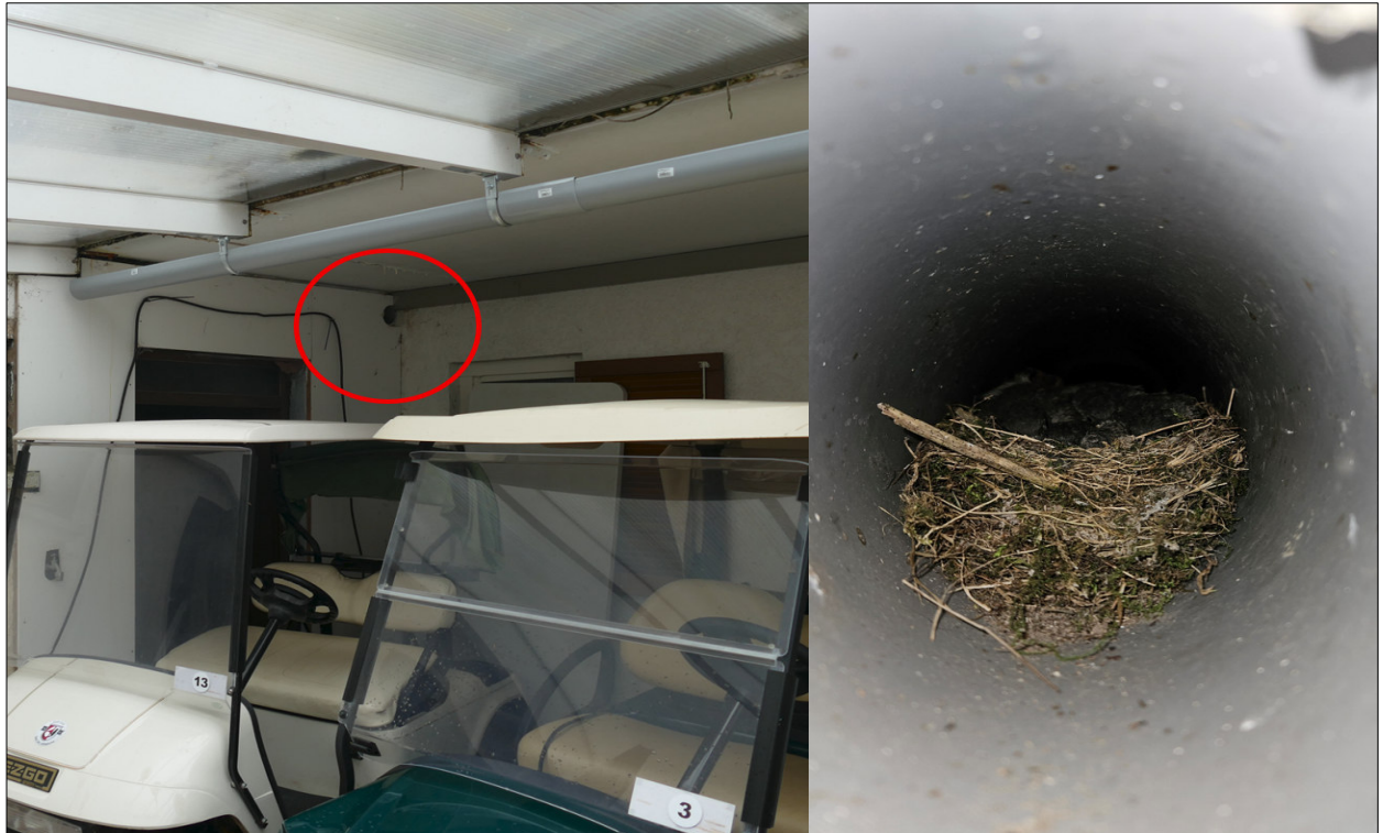
Abbildung 13: Lüftungsrohr im Bereich des Lagerschuppens mit besetztem Hausrotschwanznest (Foto: IBU Juni 2025).
