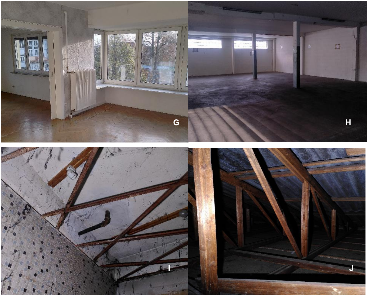
Abbildung 4: Bestandsfotos [Kunz 2025] A: Gebäudekomplex von außen; B: Blick in den Hof; C, D: Blick auf das Wohn-/Bürogebäude; E und F: Vordach; G: Wohn-/Bürogebäude innen; H: Lagerhallen von innen; I: Deckenstreben Halle innen; J: Dachraum Satteldach
