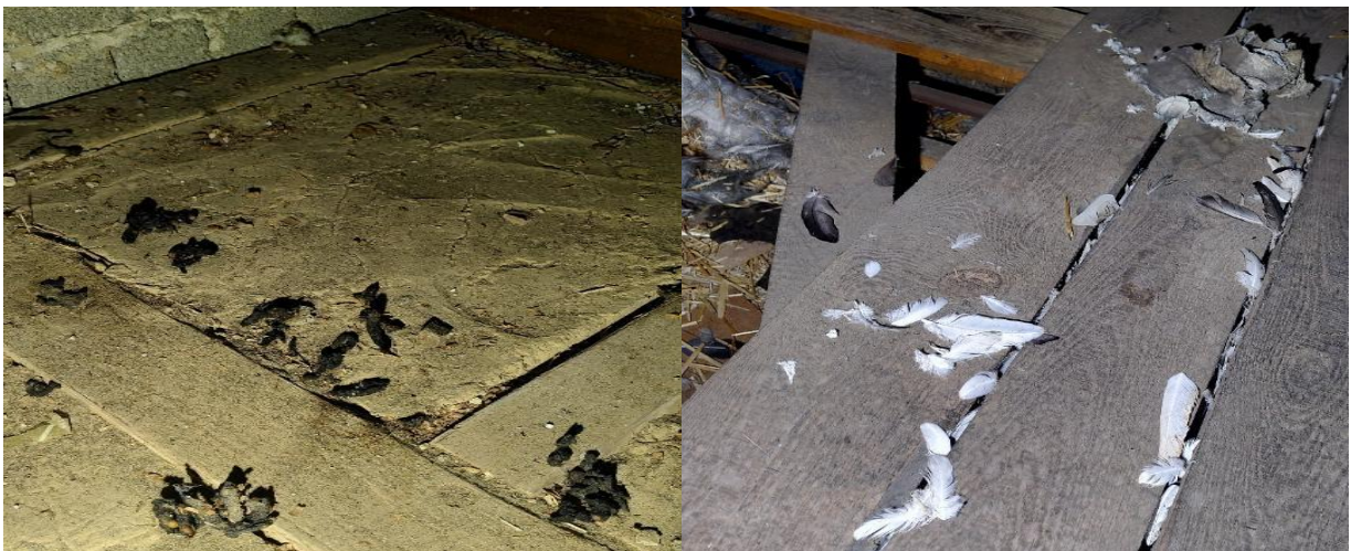
Abbildung 5: Kotspuren und Nahrungsreste im Dachraum (Foto Kunz 2025)
